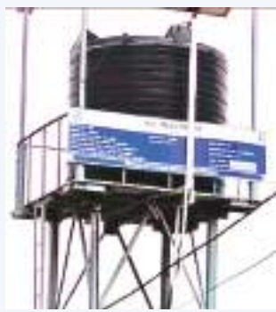
नल जल योजना के तहत लगाई गई पानी की टंकी।
