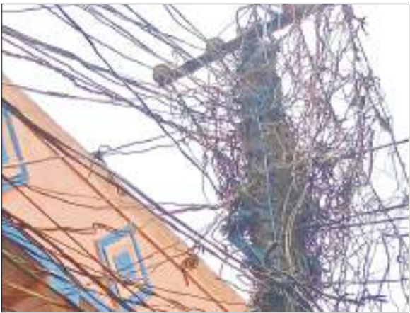
उलझे बिजली तारों के मकड़जाल के बीच रह रहे हैं बस्तीवासी।
