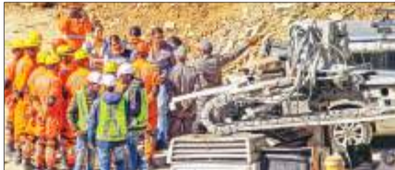
दिया गया। सुरंगों के मुताबिक, बचाव अभियान में इस्तेमाल लाई जा रही अमेरिकी ऑगर मशीन में तकनीकी खराबी आ गई है। मशीन आगे नहीं बढ़ पा रही है। मशीन का बेयरिंग खराब हो रहा है। कहा जा रहा है कि अब तक मशीन सिर्फ 24 मीटर तक ही ड्रिल करके पाइप डाल पाई है। शुक्रवार को अब तक सिर्फ छह मीटर तक ही पाइप सुरंग के भीतर जा चुका
